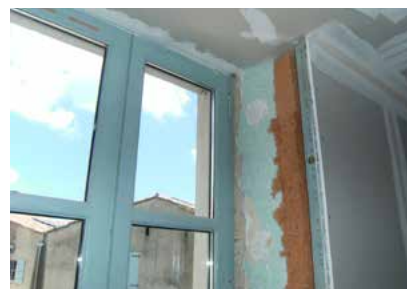
Isolation des murs donnant sur l'extérieur en matériaux durables (laine de bois 150 mm)
